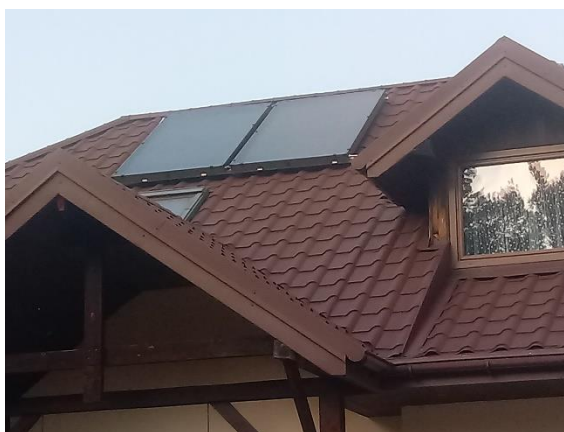
Zamontowane w ramach projektu kolektory słoneczne
